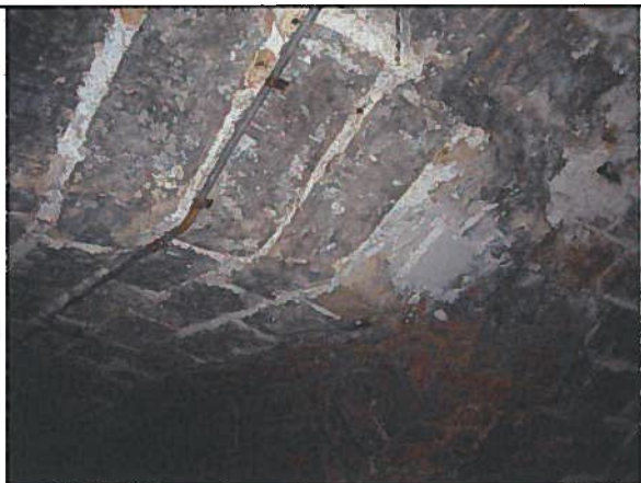
fig 5 : Fissure 1 transversale dans passage des caves, cave 2
