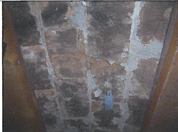
fig 3 : Chutes de pierre partielles, cave 1
