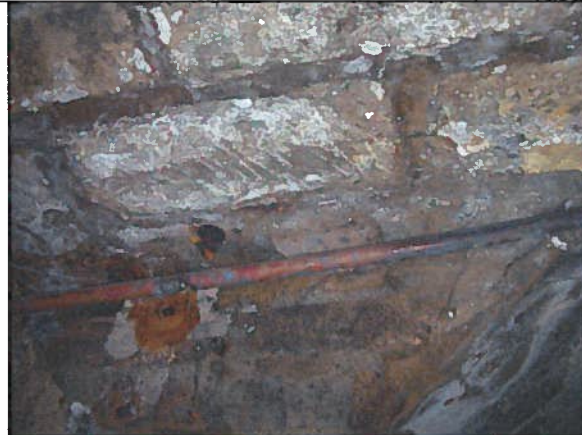
fig 4 : Chutes de pierre partielles à proximité de pièces métalliques, cave 2
