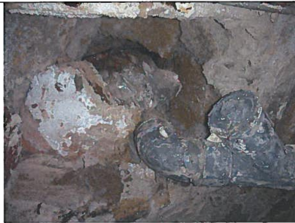
fig 2 : Présence de canalisations dans la zone de chute des claveaux
