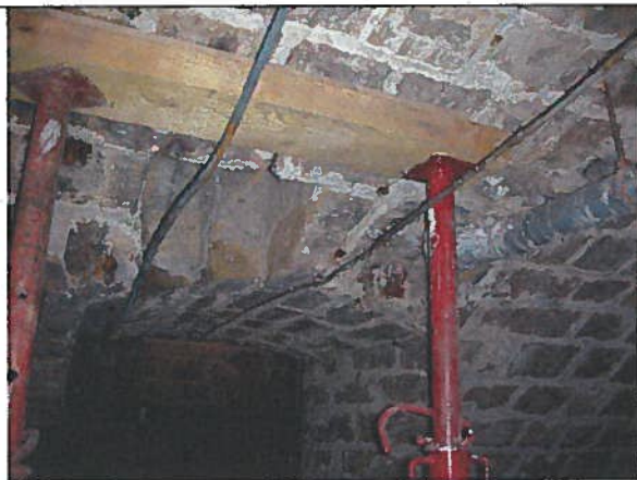
fig 1 : Chute des claveaux entre caves 1 et 2
