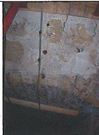
fig 6 : Fissure 1 transversale dans passage des caves, cave 2
