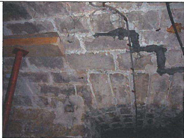
fig 7 : Fissure 2 à proximité de la fissure rebouchée, cave 1
